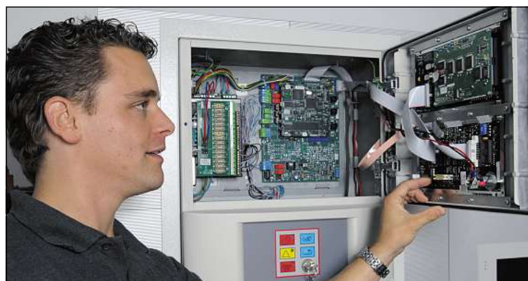
Servicetechniker bei der Wartung einer Brandmeldeanlage.
