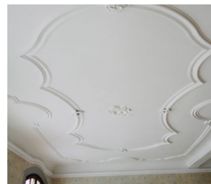
Unsichtbar in die Deckenstukkatur eingebaut: Rauchansaug-Sonde.
